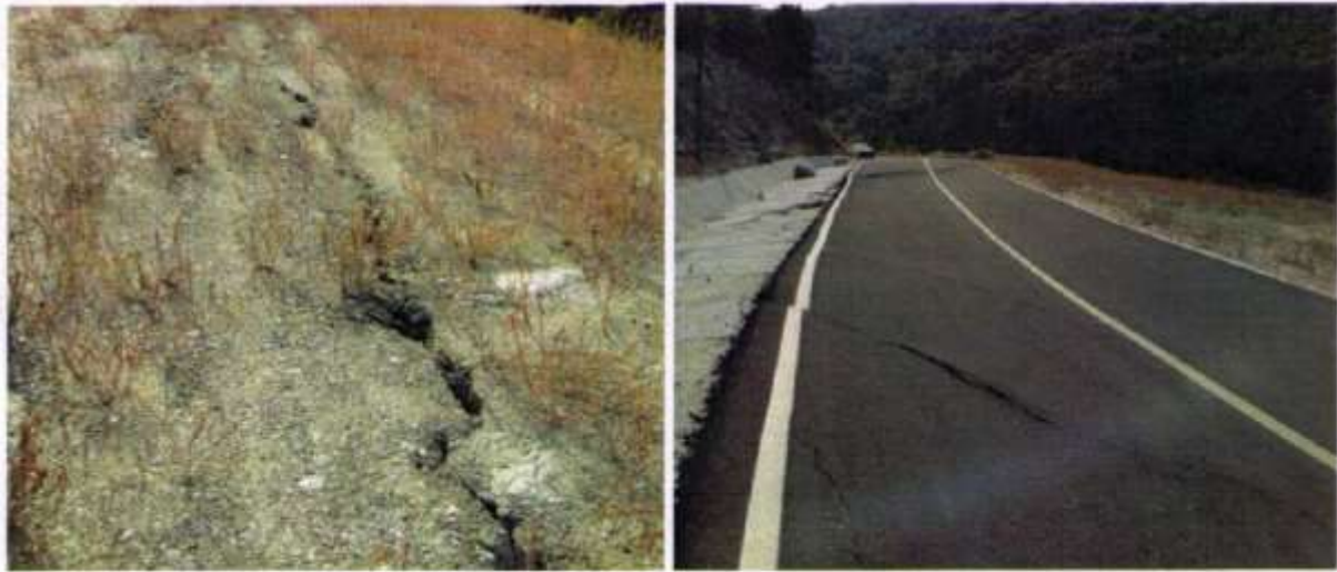
Şekil 2. Yol boyunca meydana gelen çatlaklar ve kaymalar
