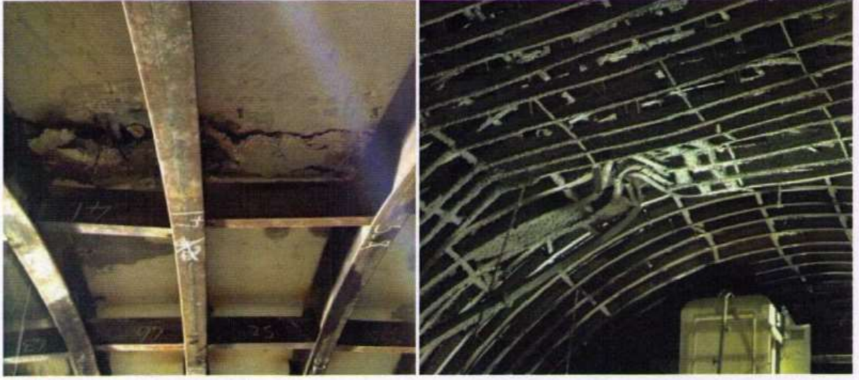
Şekil 3. Segmentlerde meydana gelen hasarlar ve IPN profiller ile güçlendirilmiş hali
