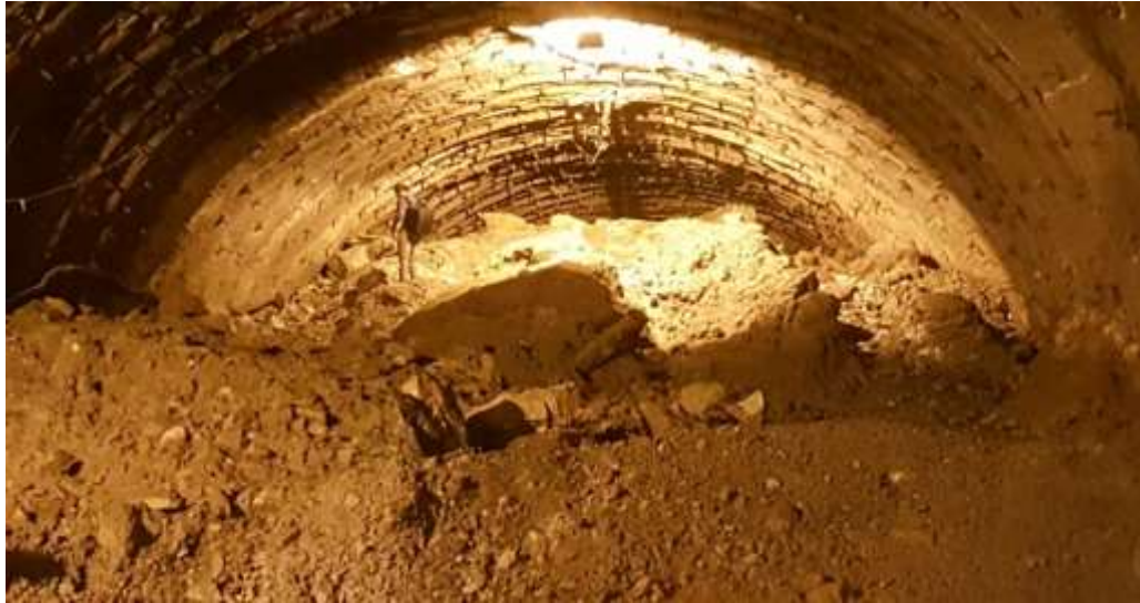
Şekil 3. Göçük sonrası tünel içerisindeki durum
