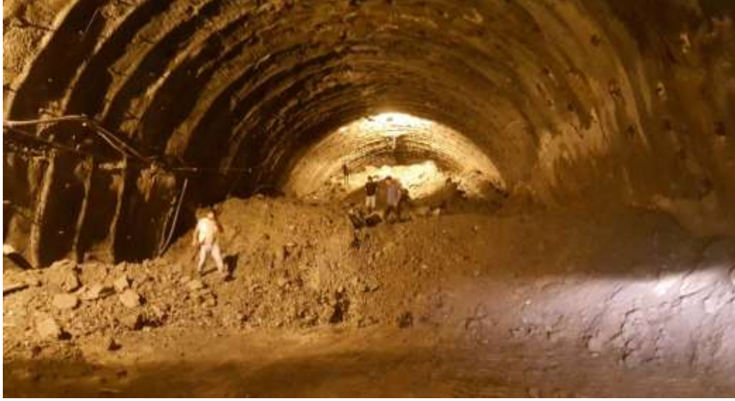
Şekil 2. Göçük sonrası tünel içerisindeki durum
