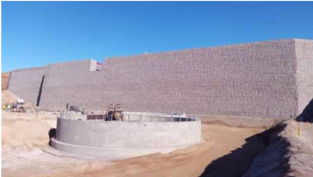
Şekil 10. Terramesh sistem ile kırıcı ünitesi duvarı (Maccaferri Türkiye – Anagold Erzincan Çöpler Altın Madeni)
