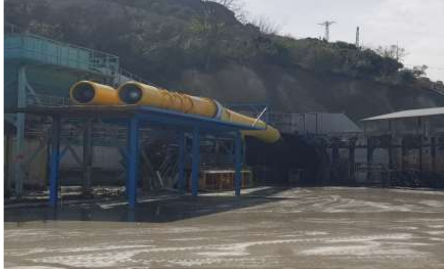
Şekil 4. Üretim desandresi havalandırma ekipmanları (fanlar)
