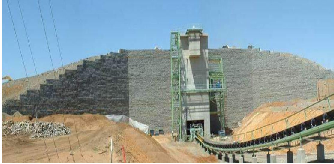
Şekil 4. Kırıcı ünitesi duvarı (Maccaferri Marikana, Platin Madeni)
